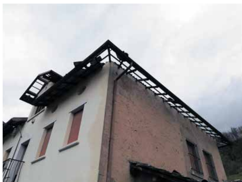
I danni del maltempo al tetto della canonica
