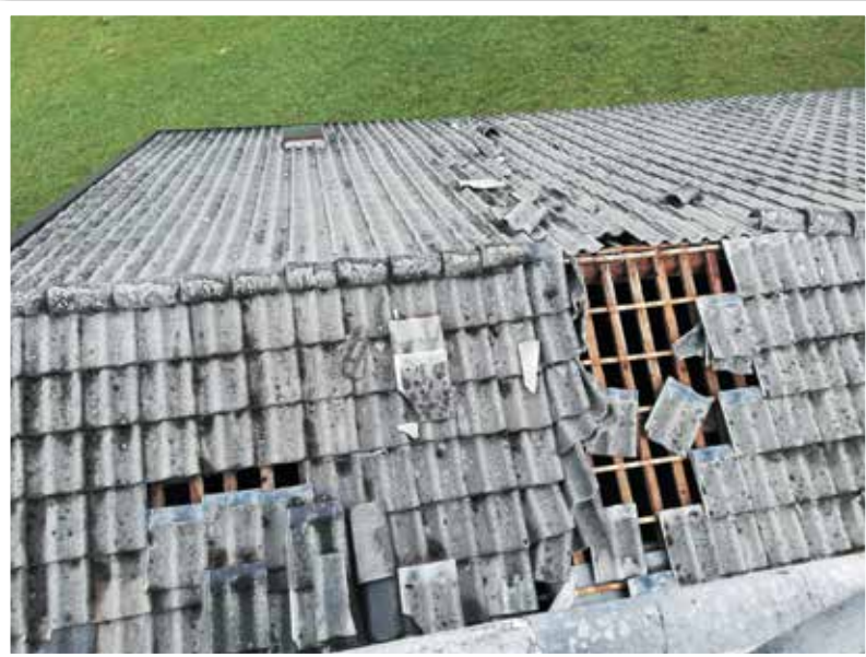
Il tetto della chiesa parrocchiale dopo la tempesta di vento
